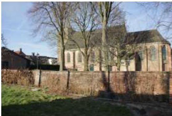
De slagenmuur bij de kerk is hard aan restauratie toe
